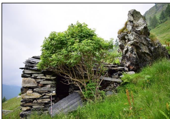
Figura 20. VMS023-01: baita costruita al di sotto di un grande blocco emergente dal versante.
