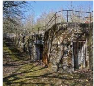
Ouvrage du Bas du Chene State of abandonment
