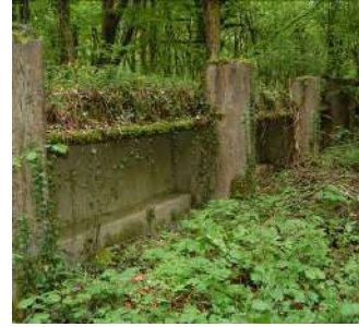
Ouvrage du Haut-Bois State of abandonment
