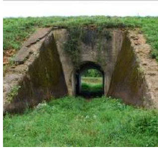
Ouvrage de la Cote d'Essert State of abandonment
