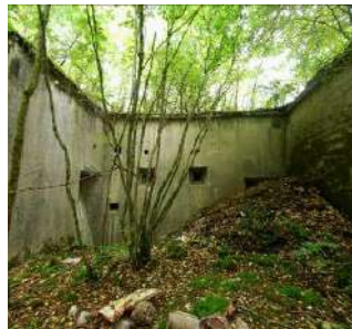
Fort du Bois d'Oye State of abandonment
