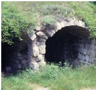
Batteria Candriai Destruction - loss
