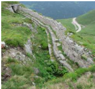
Trenches Fieudo di Sotto State of abandonment
