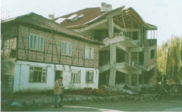
Figura 2.6: Costruzione tradizionale affiancata a costruzione in c.a. dopo il terremoto di Duzce 1999, Doğançün e altri (2006).
