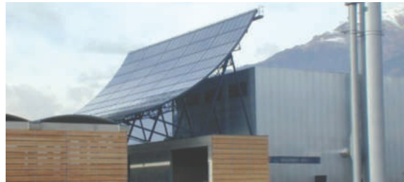
Collettori solari per acqua calda, Heizhaus-lienz, Germania Solar thermal collectors for hot water, Heizhaus-lienz, Germany
