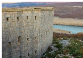
10. Fort Drakuljica - Bileca (Bosnia-Erzegovina) - Stato di abbandono
