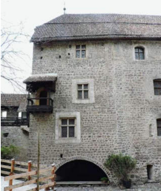
Abb. 62 Runkelstein bei Bozen, Baufuge an der Ostseite des Westbaus
