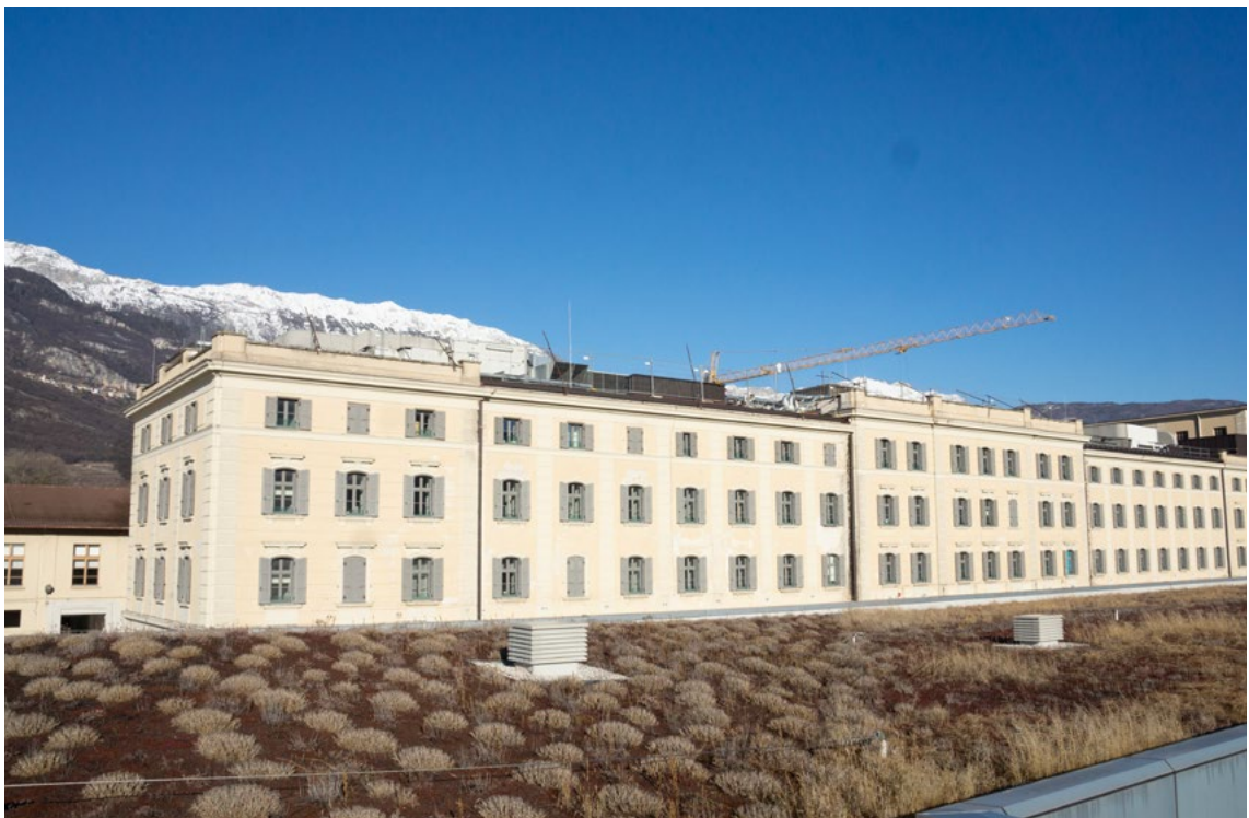
Facciate dell'edificio in ristrutturazione per la sede del CIMeC, Archivio UniTrento, ©Michela Favero 2023
