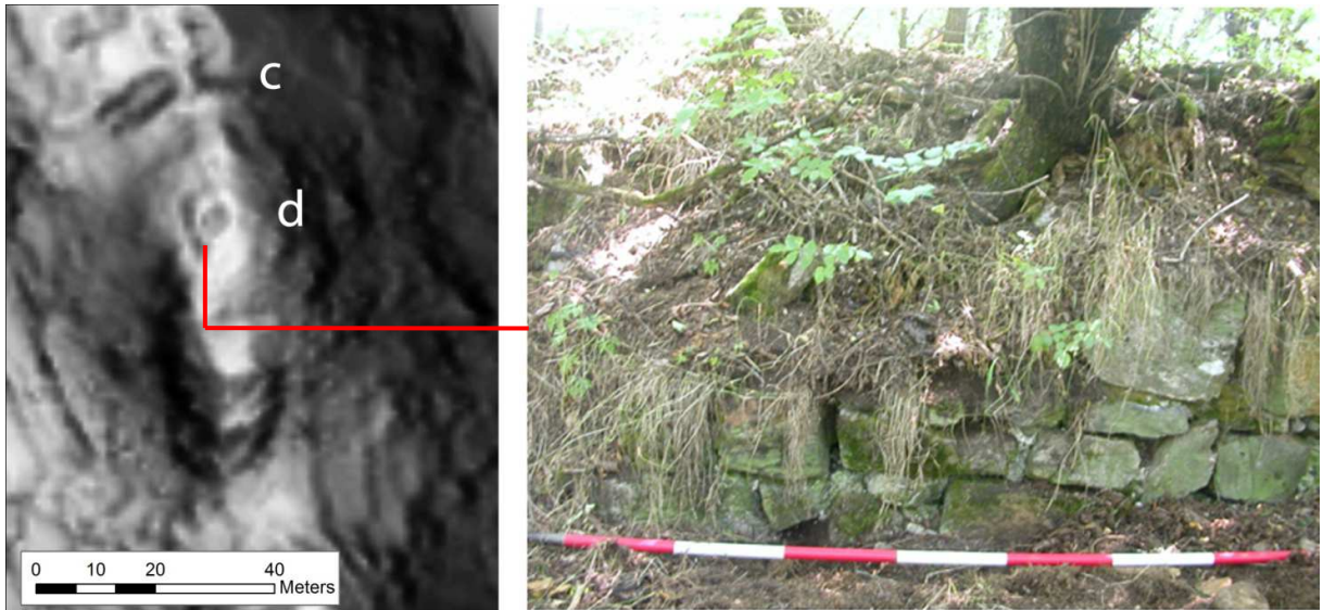
Figura 150. TS06, Colle Tegazzo. La struttura muraria che corrisponde con il limite occidentale dell'anomalia d (Area B).
